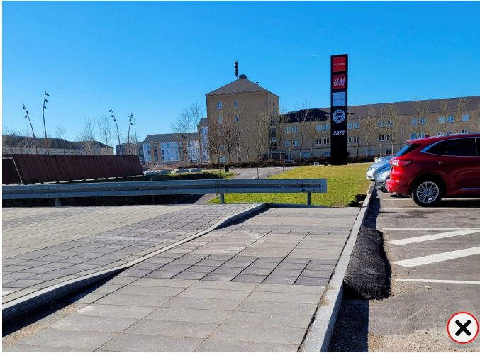
Figur 7.8 Løsning før ombygning - For stejl udvendig rampe til parkeringsareal
