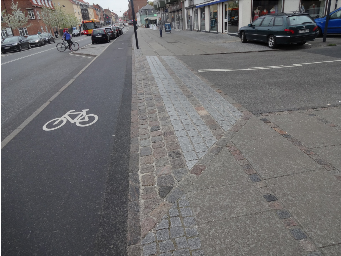
Figur 4.17 Overkørsel mangler sammenhængende jævn belægning.
