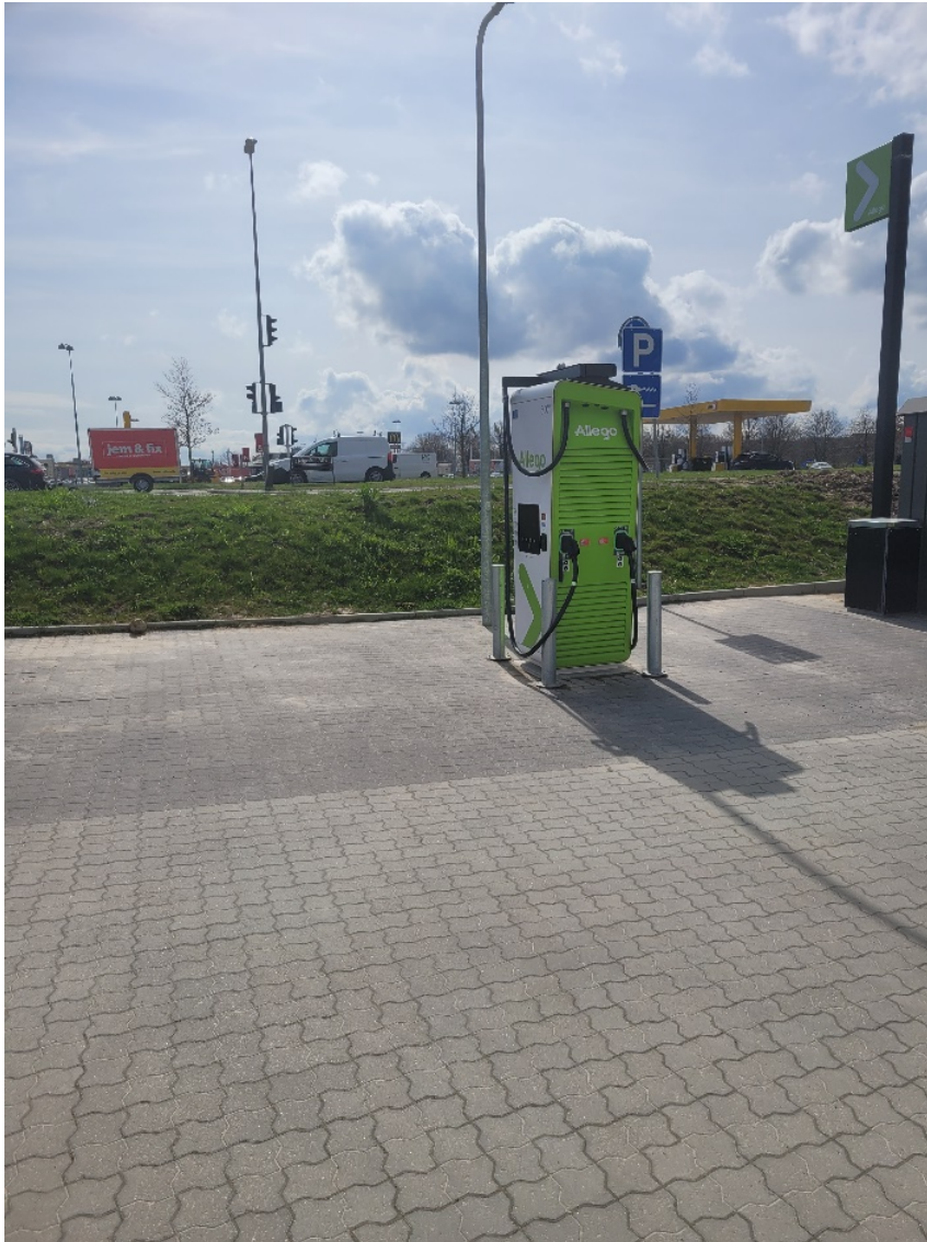
Figur 7.13 Lynladestander med stolper som værn tæt på standeren. Ingen markering af en parkeringsplads. God plads rundt om standeren.
