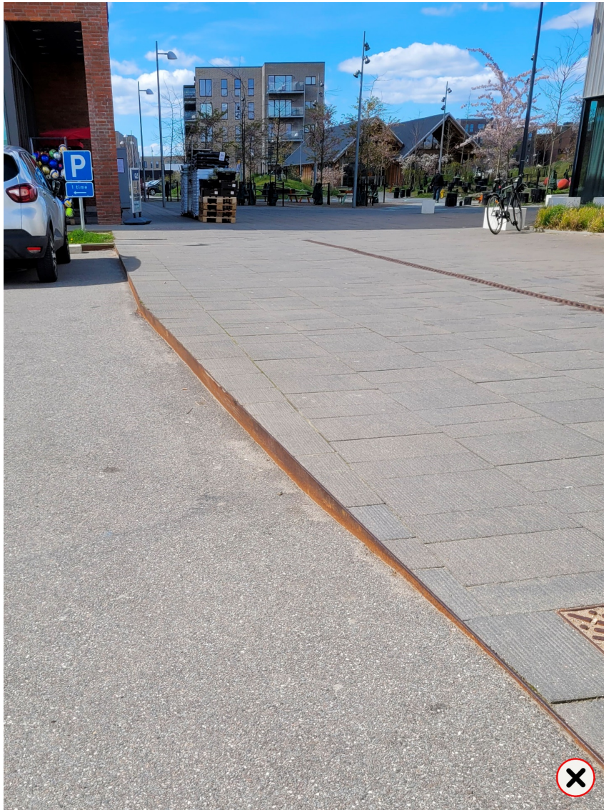
Figur 6.7 Skrå vertikal kant ved parkeringsplads ved supermarked ej markeret. Kanten er skrå på en strækning af ca. 10 meter. Den er ikke markeret og er dermed ikke synlig for personer, der går på fortov.
